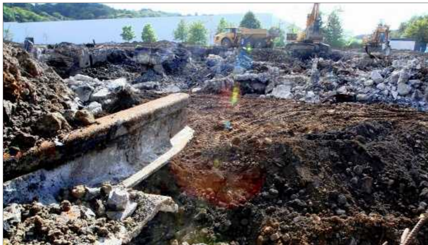
Les ouvriers creusent là où se trouvaient les accumulateurs à minerai. Photo Etienne JAMINET
